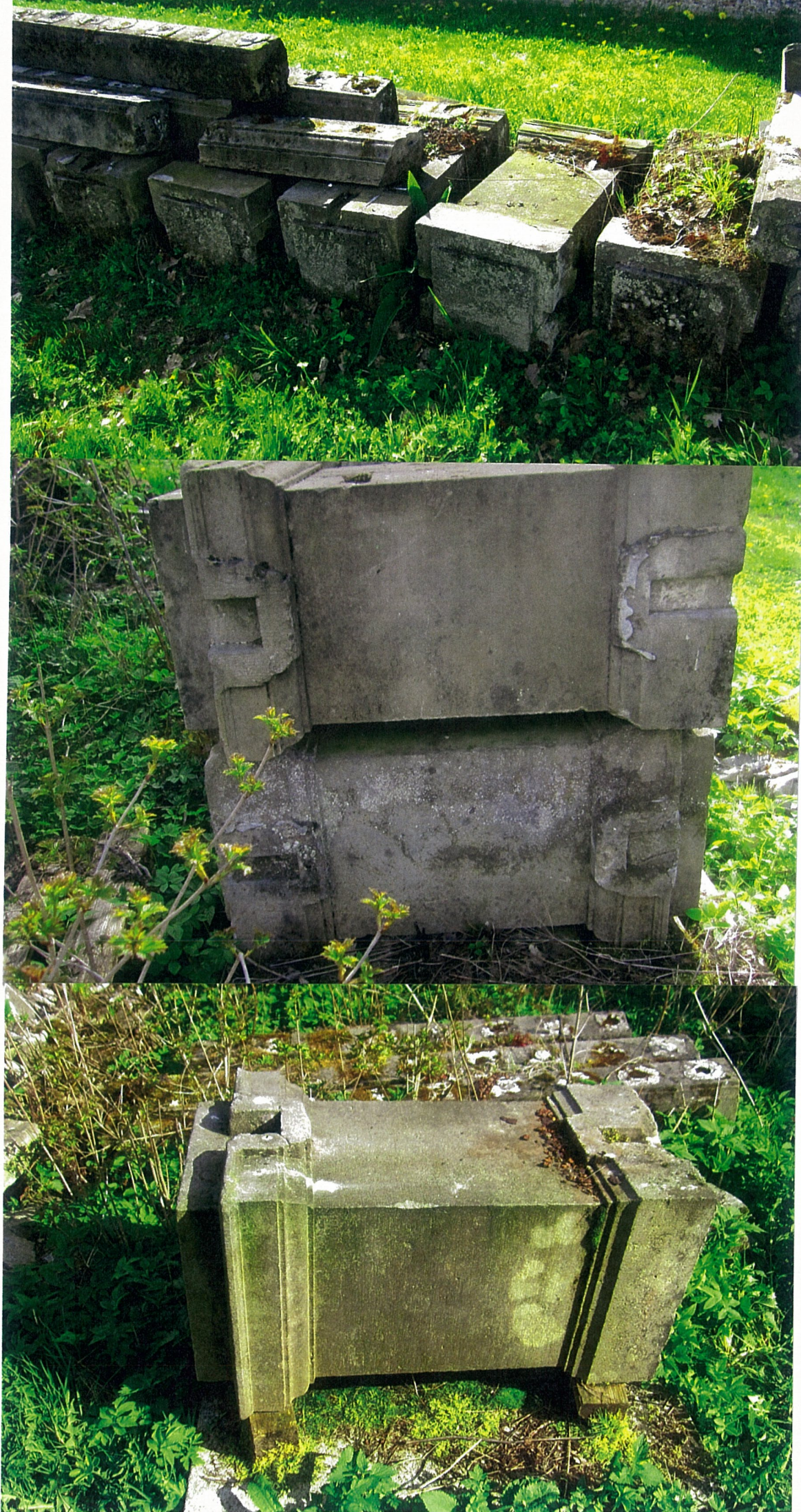
DALŠÍ FOTO PILÍŘŮ A JEJICH STAV
