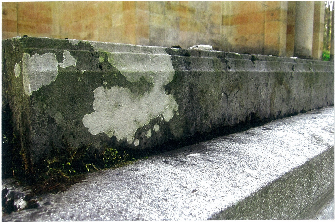
DETAIL POVRCHOVÉHO ZNEČIŠTĚNÍ TRNOŽE, DOLE FOTO TRNOŽÍ PO STRANÁCH SCHODIŠTĚ DO KRYPTY OSAZENÉ PŘI MINULÉ REKONSTRUKCI
