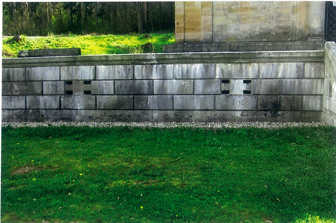
LOKÁLNĚ TMAVÉ DEPOSITY NA JEDNOTLIVÝCH KVÁDRECH. DOLE FOTO KAMENNÉ KAPSY V ŘÍMSE PRO OSAZENÍ PÍSKOVCOVÝCH PILÍŘŮ
