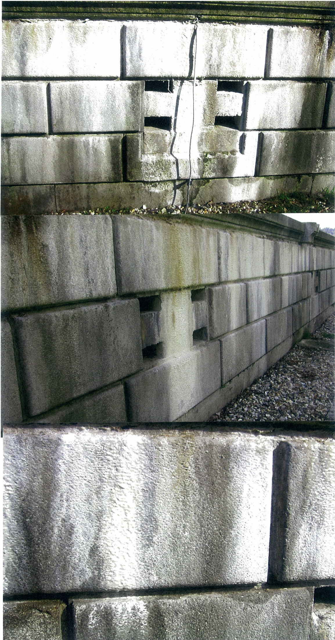
DETAILY ZNEČIŠTĚNÍ POVRCHU, LOKÁLNĚ STOKY A ZVÁPENATĚLÉ KRUSTY
