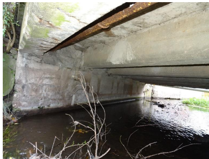
Podhled ve směru k OpL. Patrná koroze ocelové trubky cizího zařízení.
