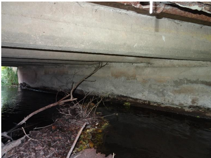
Pohled na OpP. Podemletí v úrovni hladiny normální vody a naplaveniny v průtočném profilu.
