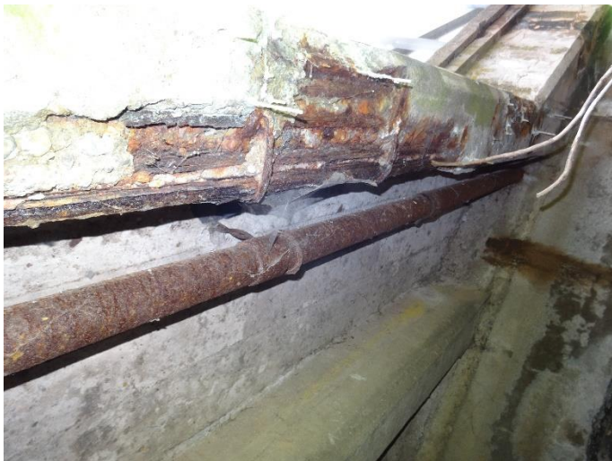
Odpadnutá krycí betonová vrstva. Značná koroze výztuže.
