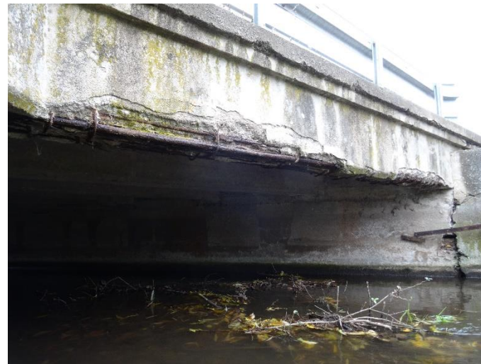
Obnažená výztuž. Zajištěná svislá trhlina mezi opěrou a křídlem.
