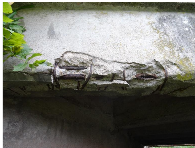
Odpadnutá krycí vrstva betonu a výrazná koroze výztuže.
