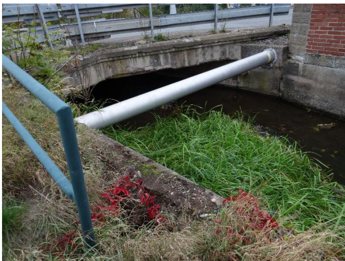
Hluboká prohlubeň za navigační zdí v blízkosti mostu.
