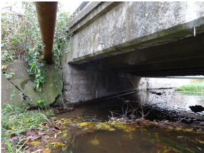
Svislá trhlina mezi OpP a navazujícím křídlem. Šikmá trhlina na křídlem.
