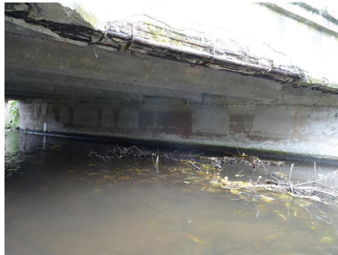
Pohled na OpL. Odpadnutá krycí vrstva betonu a koroze výztuže.
