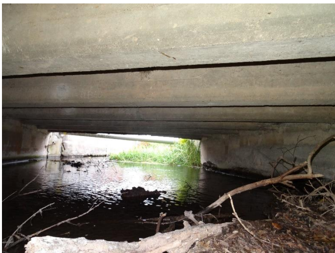
Podhled nosné konstrukce ve směru toku. Naplaveniny v průtočném profilu.
