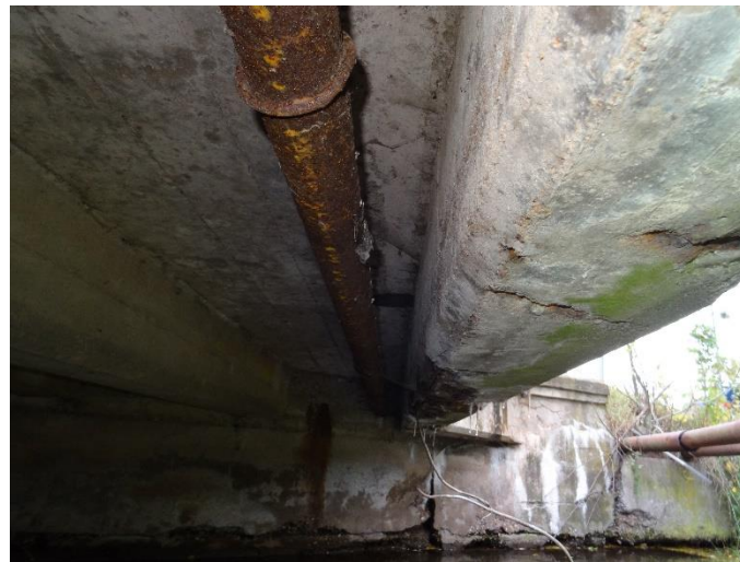
Podhled ve směru k OpP. Podemletá opěra, vydrolený beton spodním líci nosníku a vápenné krápníky. Svislá trhlina mezi opěrou a křídlem.
