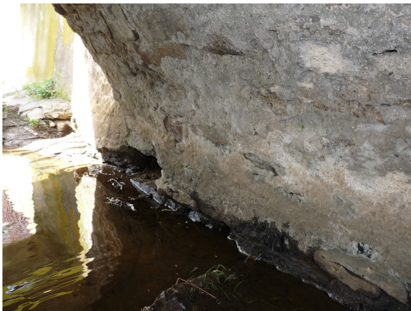
Podemletá pata opěry OP1 vpravo
