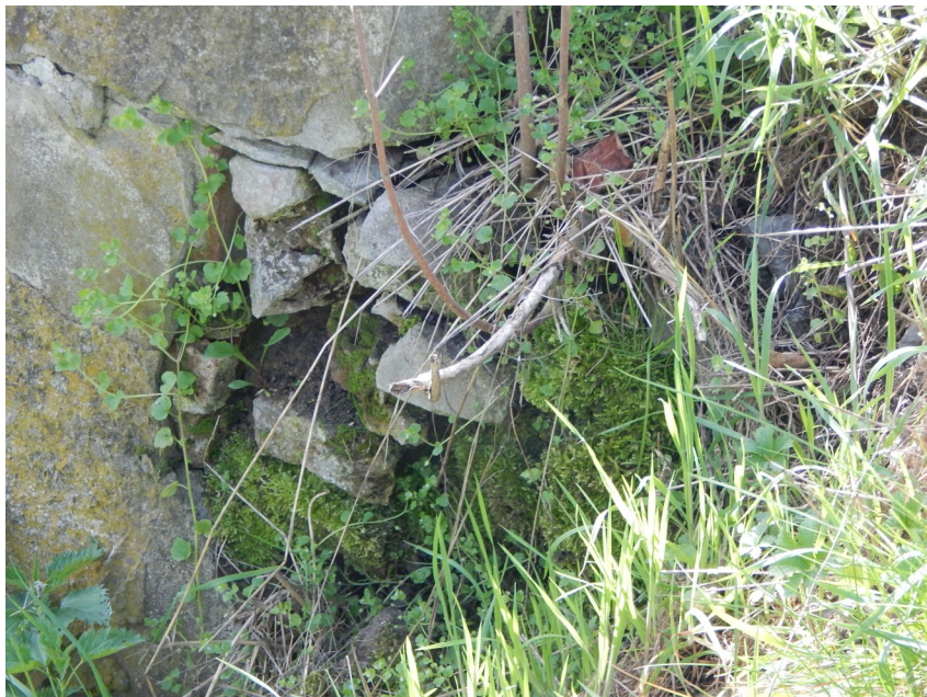
Rozvalené zdivo levého křídla
