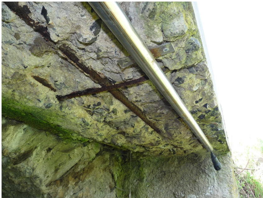
Obnažení a korozi zeslabená ocelová výztuž rozšířené části
