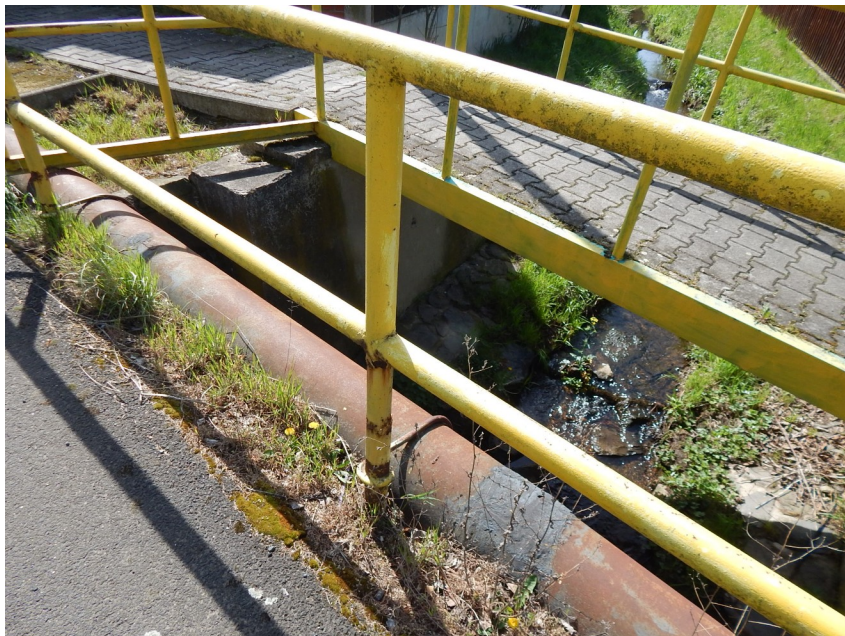
Deformace sloupků, koroze zábradlí
