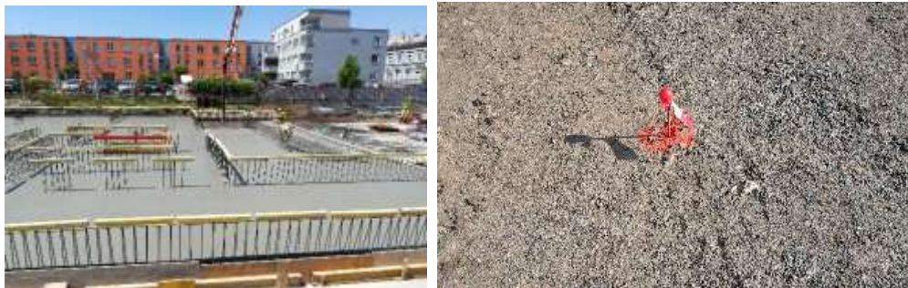
Obrázek 18 Krytí betonářských ocelí
