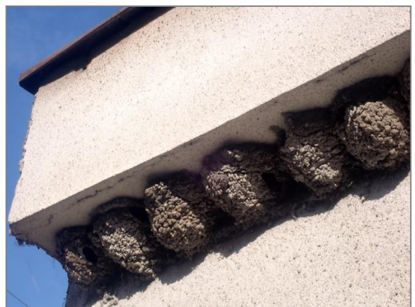
Kolonie jiříček pod atikou na východní přístavbě
