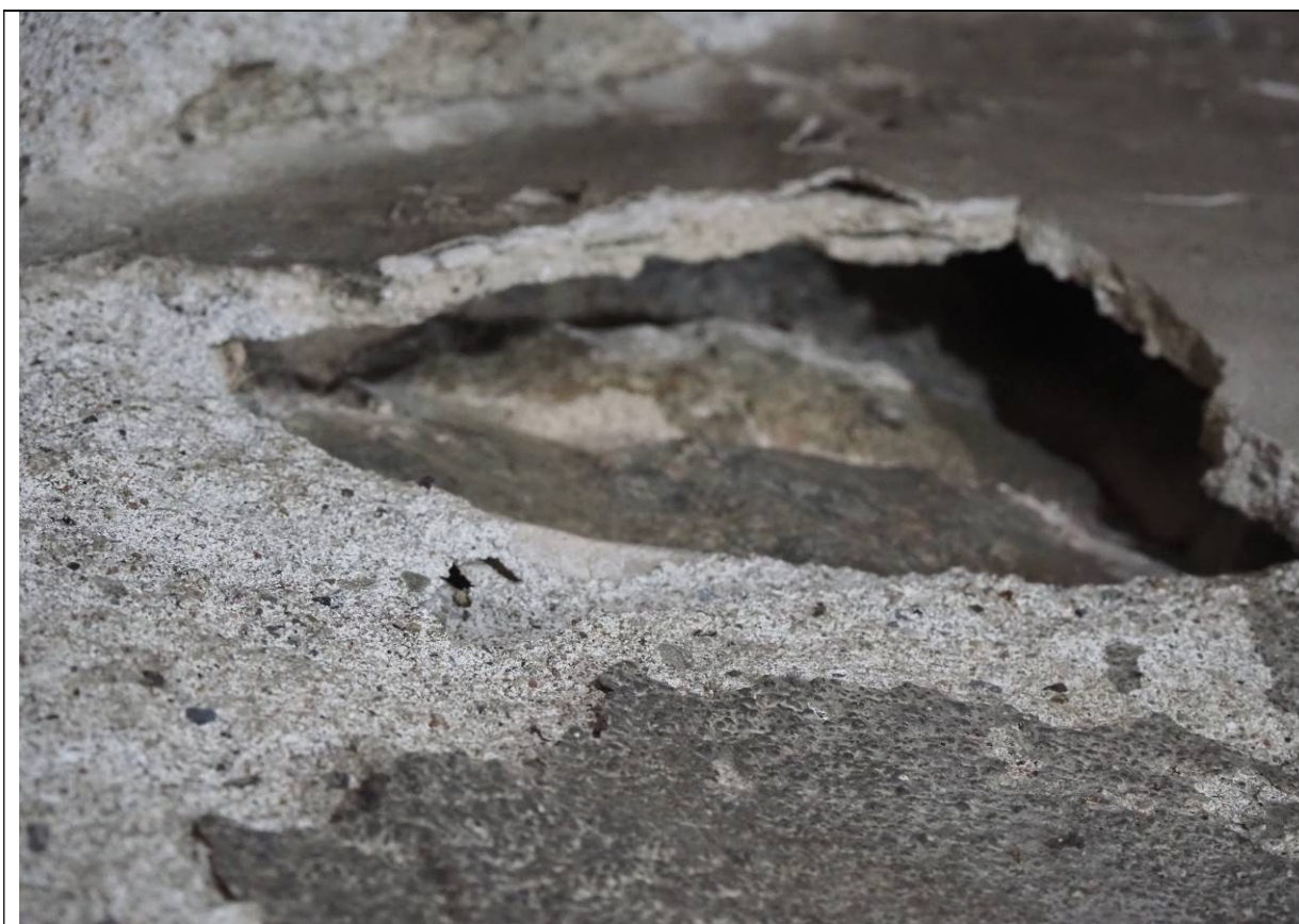
Otevřená dutina pod souvrstvím omítek.
