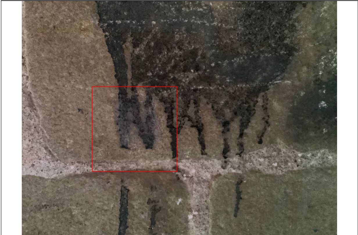
Zkouška čištění asfaltových graffiti laserem. Na tento typ znečištění není laser vhodný.
