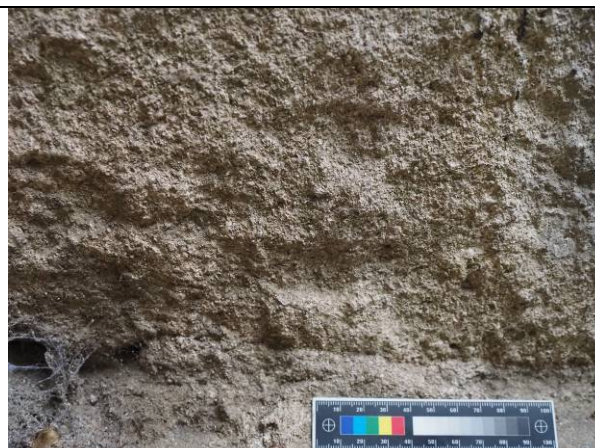
Degradace vápence se ztrátou povrchu.
