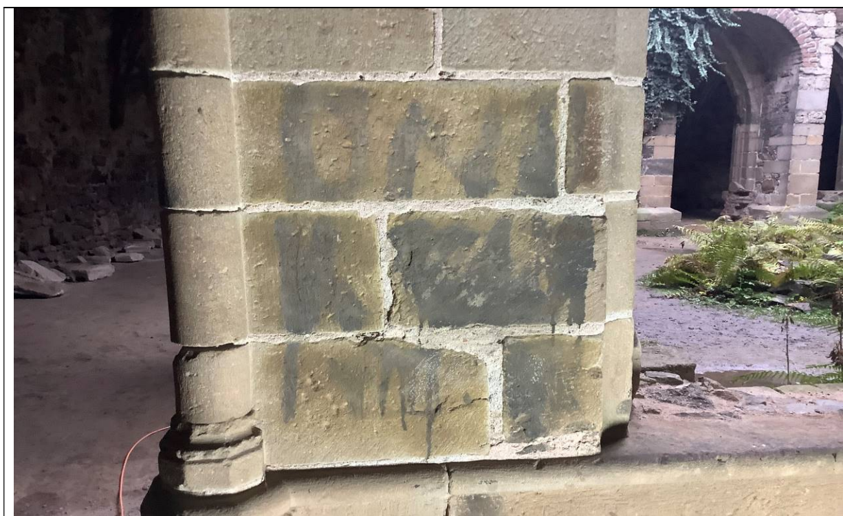
Nevhodné nápisy provedené pravděpodobně asfaltovou barvou, které byly již v minulosti přetřeny okrem. Tyto nátěry jsou vpité do hmoty kamene a lze je odstranit pouze částečně chemicky a mikroabrazivně. Jejich rezidua budou barevně zaretušována, tak aby co nejméně rušila.
