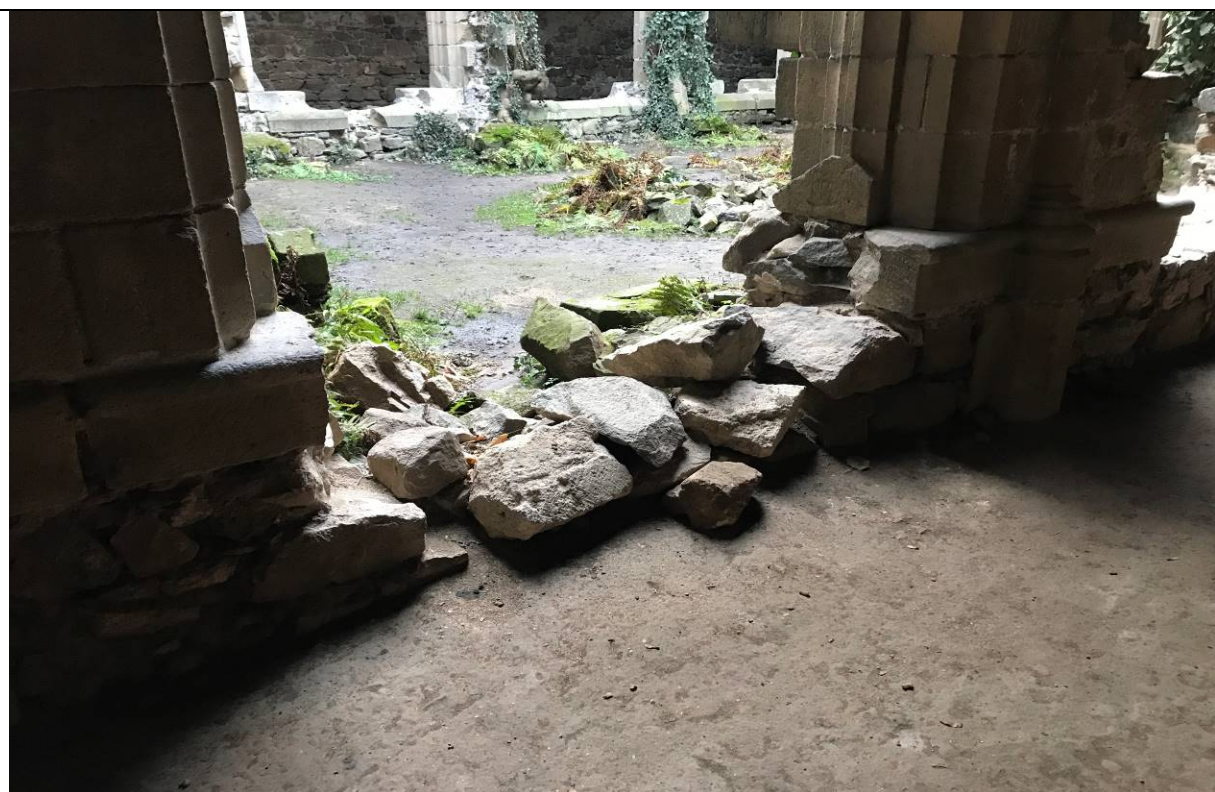
Některé parapety včetně parapetních zídek arkády ambitu jsou dezintegrované a chybí jejich části. Zdivo bude restaurátorsky ošetřeno a chybějící hmota bude doplněna odlišitelným, ale estetický nerušivým způsobem.
