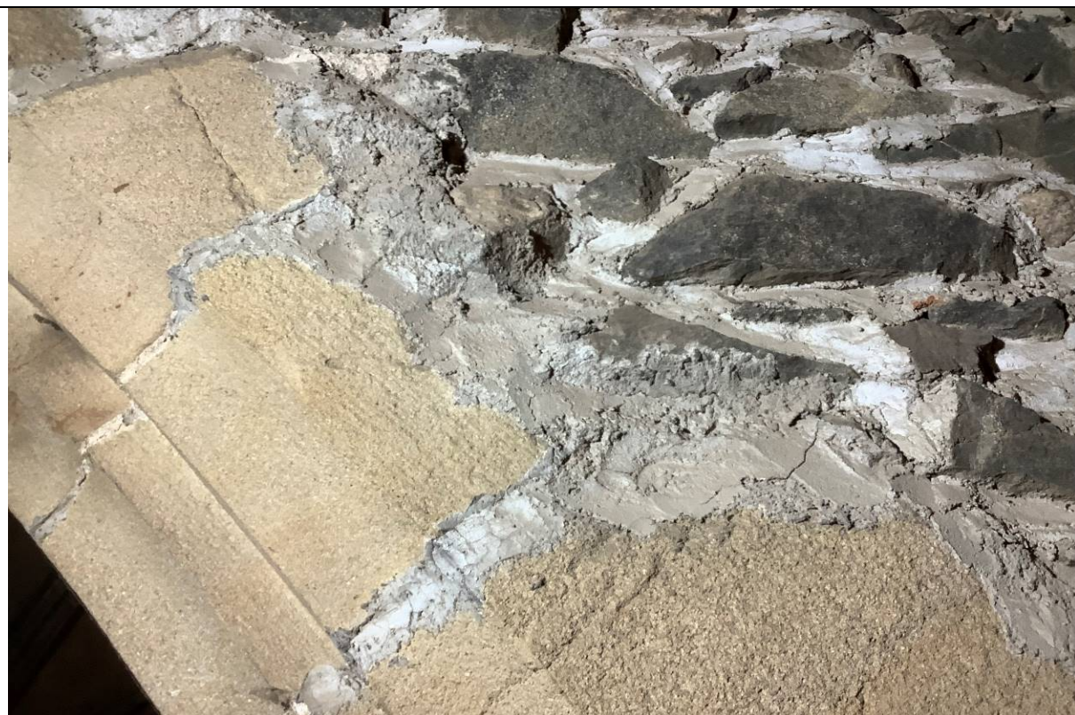
Esteticky a technologicky nevhodné spárování kvádrů ostění a lomového zdiva, které je třeba odstranit a nahradit.
