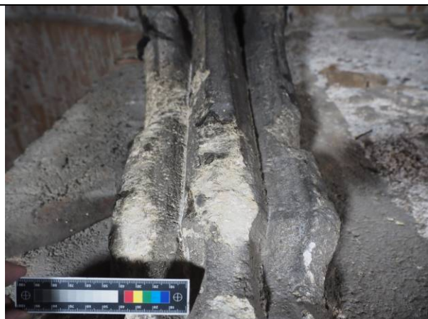
Degradace vápence s lokální ztrátou hmoty.
