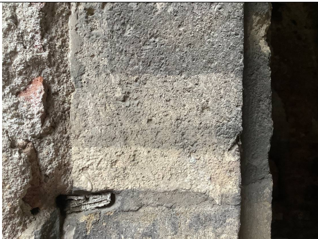
Zkouška čištění povrchu mušlového vápence laserem. Laser výborně odstraňuje korozní produkty a prachové depozity. Umožňuje různou míru čištění.
