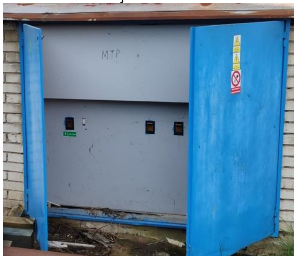
rozvaděč MTP a jističe transformátoru
