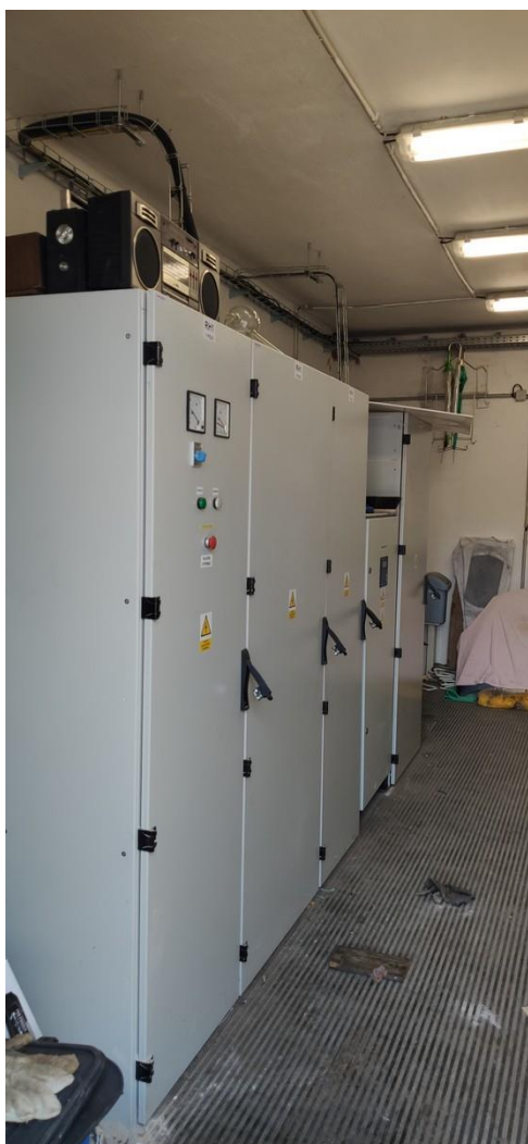
NN rozvaděč zimního stadionu
