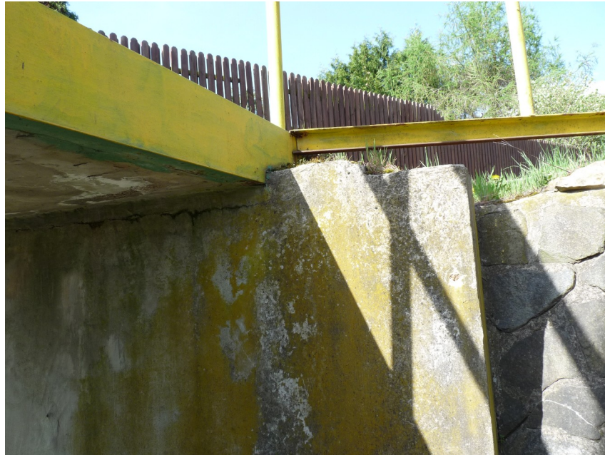
Betonové opěry lávky, beton degradovaný
