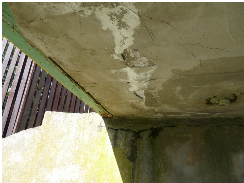
Odpadlé sanace na pohledu konstrukce lávky
