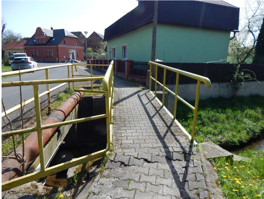
Přístupová cesta na lávku s rozpadlým nájezdem
