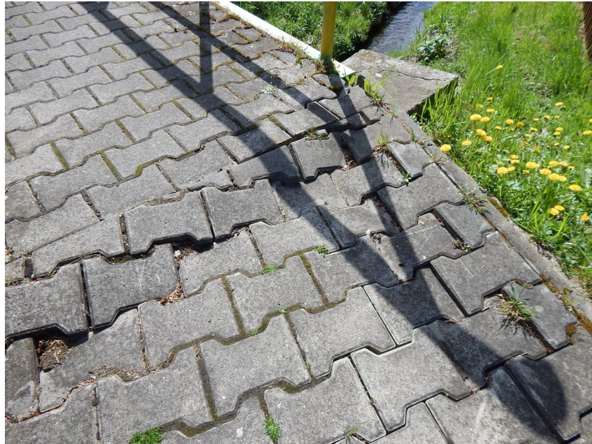
Rozvolněná zámková dlažba
