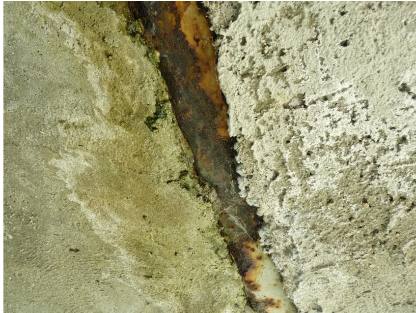
Vyčnívající korozi zeslabená výztuž nosné konstrukce na podhledu
