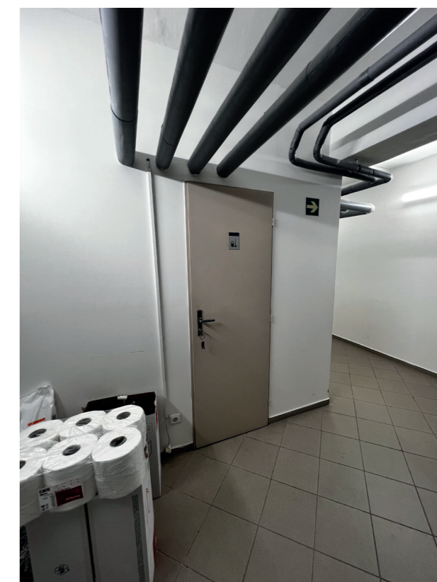
Suterén v budově A - přívod vody k automatům (úklidová místnost)
