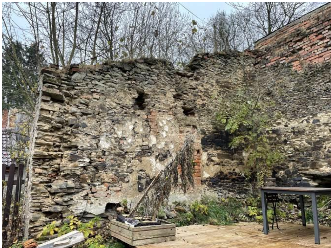
Na fotografii je vidět stav příčné stěny, která funguje jako žebro pro posuzovanou stěnu. Stav stěny není uspokojivý, stěna je silně narušena.
