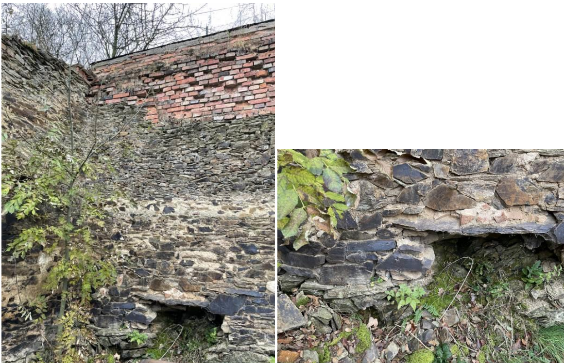
Na fotografii je vidět špatný stav cihelné části stěny a degradovaná pata kamenné části zdi.
